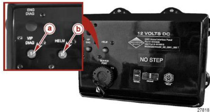
船艇集成板（VIP）的断路器
